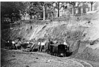
Verrohrung in der Goetheanlage
